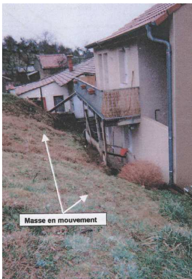
Glissement profond, conséquence de déblais et / ou remblais situé derrière la SCI de la côte à ENTRANGE
