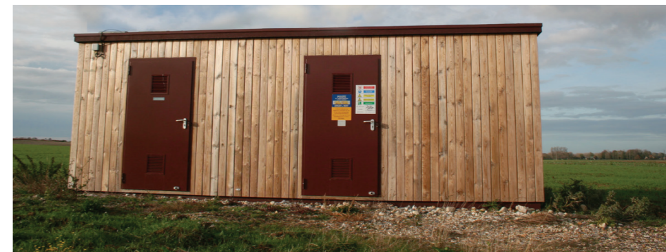
Exemple-type de poste de livraison
