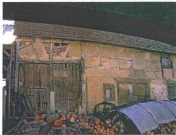
- Rue des Messieurs - Maison à pans de bois en mauvais état
