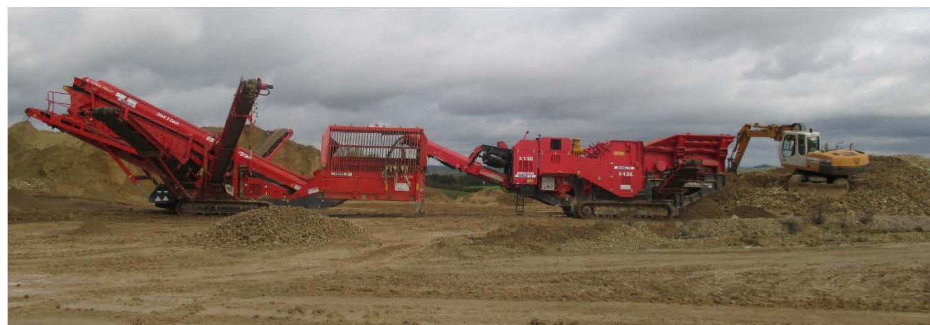
Installation de criblage-concassage
