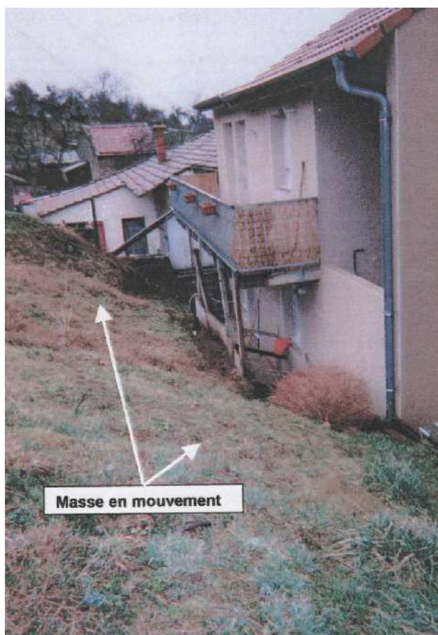
Glissement profond, conséquence de déblais et / ou remblais situé derrière la SCI de la côte à ENTRANGE
