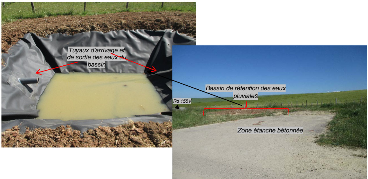
Photo 1 – Vue de du bassin de rétention/décantation des eaux pluviales. Il est à noter les tuyaux d'arrivage et de sortie des eaux du bassin
