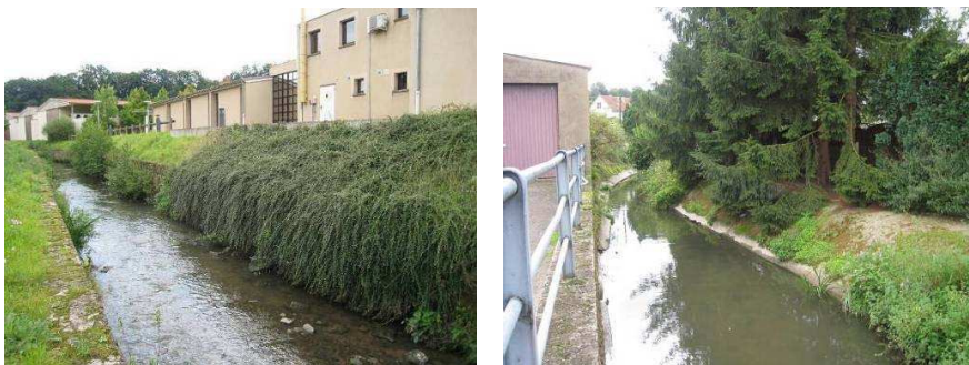
Dégradation physique des berges dans la traversée des zones urbanisées de Hombourg (présence de résineux, de plantes ornementales, berges artificialisées...)
