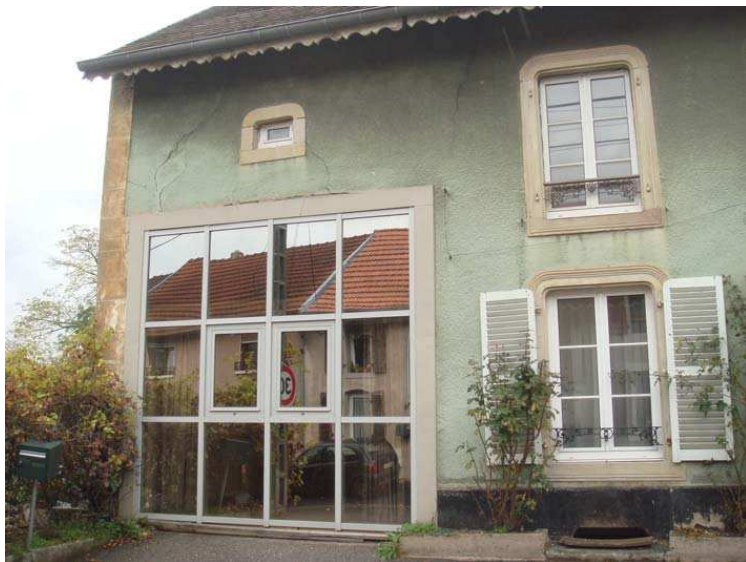
Isolation par l'extérieur, menuiseries inadaptées, modification de la modénature,...
