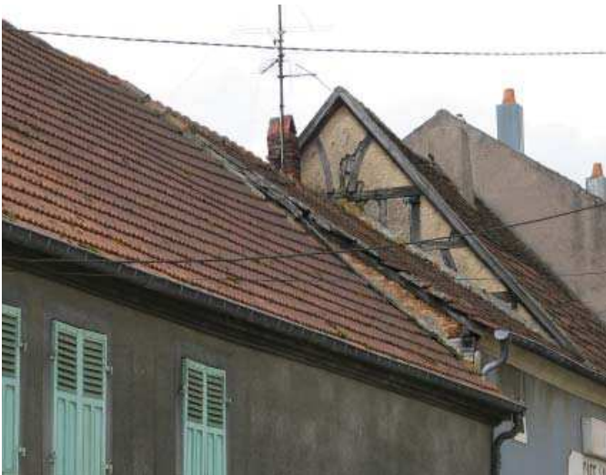
Les vestiges de pans de bois
