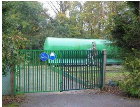
Photo 50 : la station d'épuration à la Lobe
